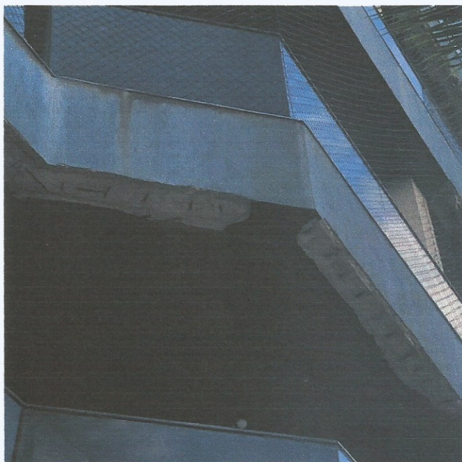
Figura 44 – Detalhe Fachada Frontal, desgaste de acabamento e armaduras expostas.
