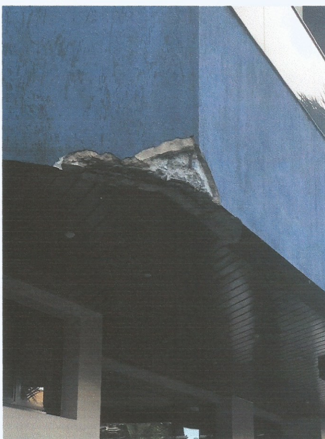
Figura 45 – Detalhe Fachada Frontal, desgaste de acabamento e armaduras expostas 2.
