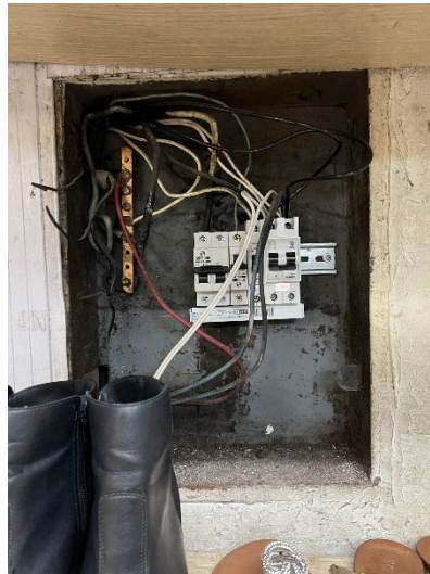
Foto 14- Vista do quadro de energia da loja 9
