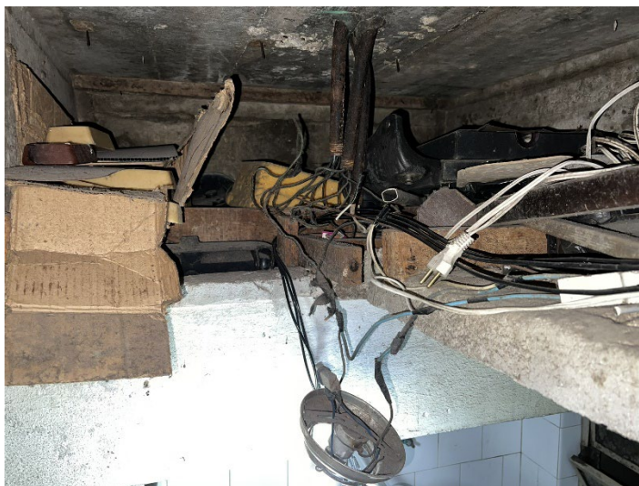
Foto 22- Vista da instalação elétrica no teto do mezanino
